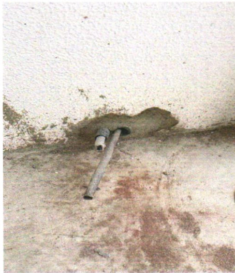
FOTO 279: TUBULAÇÃO GÁS (CASA DE GÁS)
