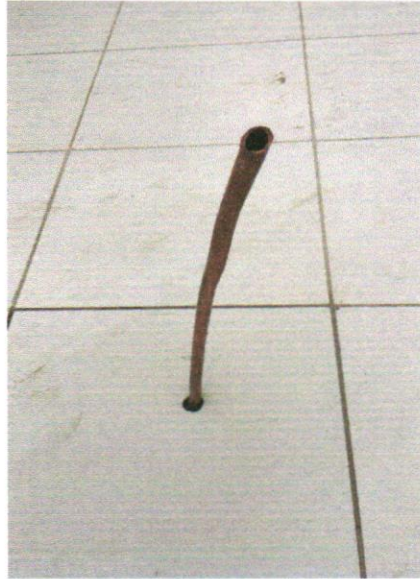
FOTO 278: TUBULAÇÃO GÁS (COZINHA)
