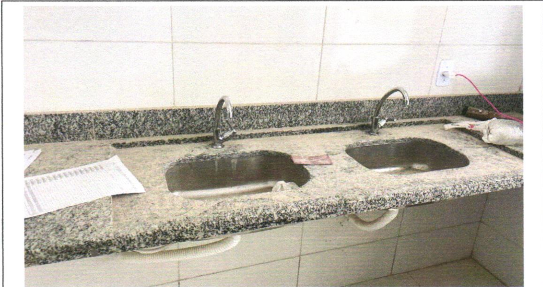
FOTO 272: CUBAS, BANCADAS E TORNEIRAS
